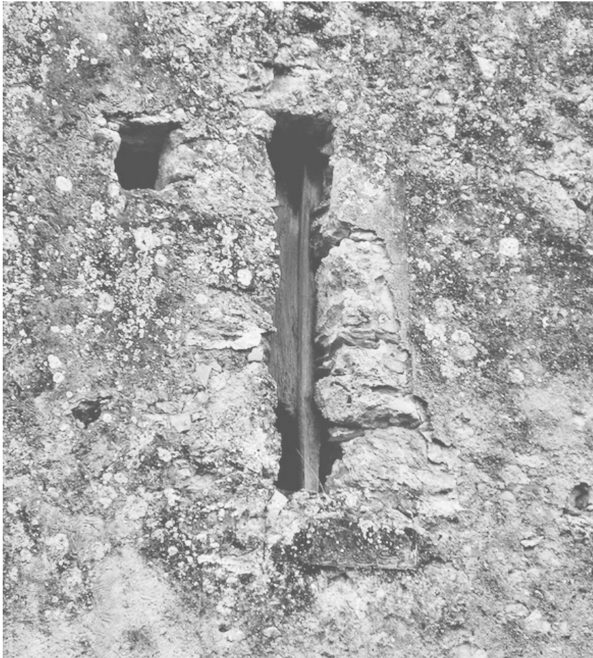
Fig. 5 - A sinistra particolare di una Monofora situata sul lato orientale dell'edificio ritratto nell'immagine precedente, prima della demolizione.
